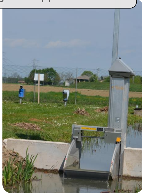
Telecontrollo e automazione: dal canale irriguo all'appezzamento
